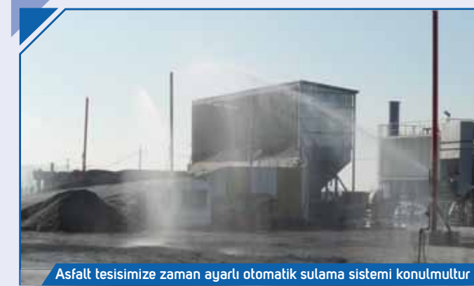
Asfalt tesisimize zaman ayarlı otomatik sulama sistemi kurulmuştur
