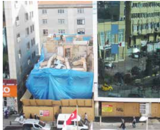
» Risk oluşturan yapılar kentsel dönüşüm kapsamında yenilenmektedir.
