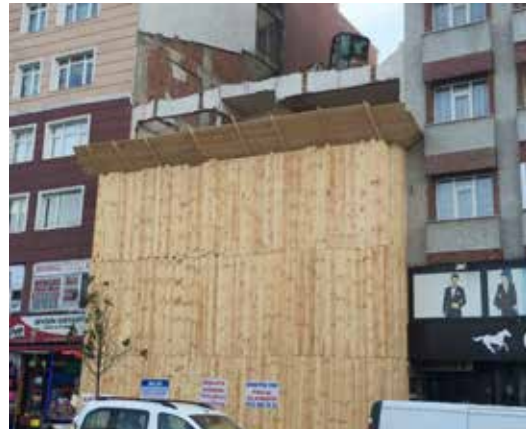
» Risk oluşturan yapılar kentsel dönüşüm kapsamında yenilenmektedir.
